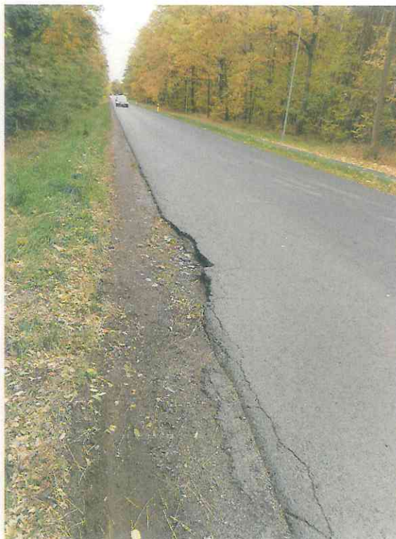
Zdjęcie 1 – uszkodzenia krawędzi jezdni i pobocza
