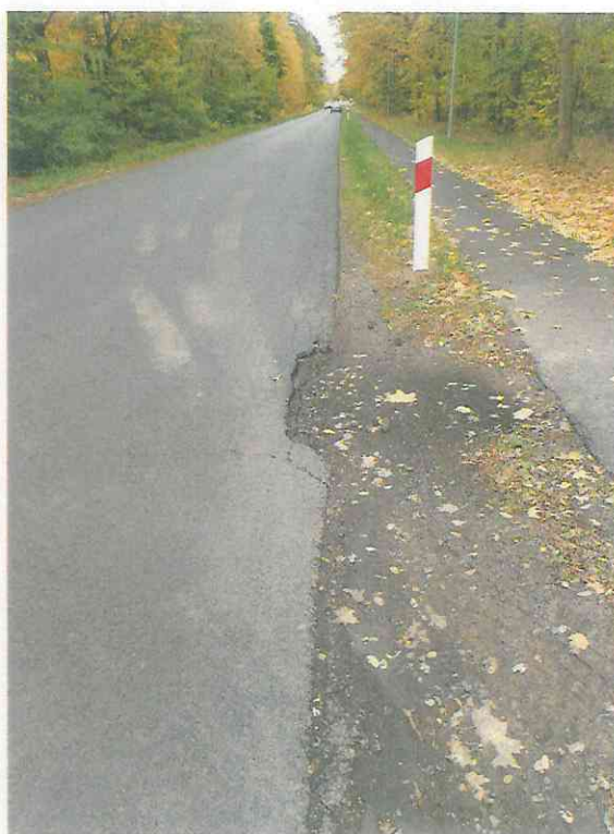
Zdjęcie 2 – uszkodzenia krawędzi jezdni i pobocza
